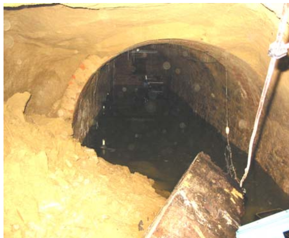
Kelleransicht am 23.12.2001 um 21.30 Uhr, Wasser steht ca 1 m hoch
