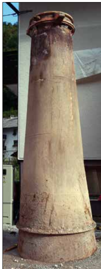
Sesalna cev, skozi katero je voda otekla iz turbine v iztočni kanal. Foto: Andrej Bogataj
