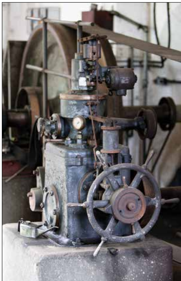
Regulator turbine (iz Sotlovca) pred rušenjem elektrarne, zadaj vztrajnik. Foto: Andrej Bogataj
